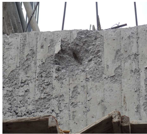
預埋於混凝土內螺栓遭拔出
